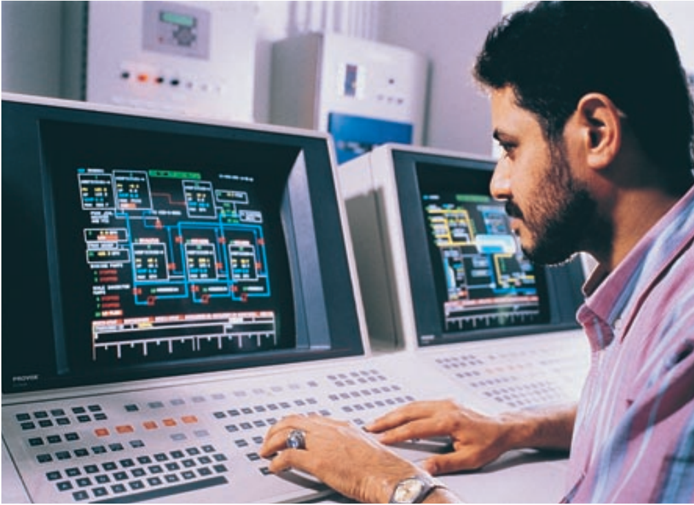
استخدام أرقى تقنيات الحاسب الآلي، في غرف المراقبة في معامل الغاز
