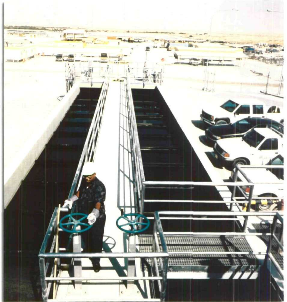
إحصائي منافع في إحدى منشآت أرامكو السعودية لمعالجة مياه الصرف
