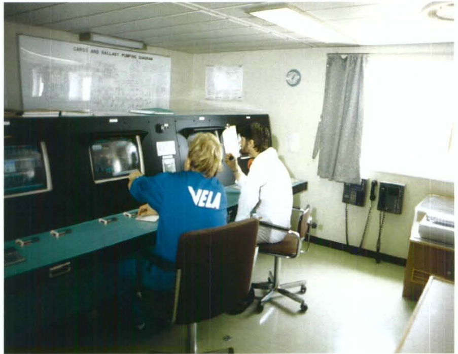
غرفة مراقبة وتحكم شحن وتبريق البترول الخام في إحدى ناقلات الشركة.
