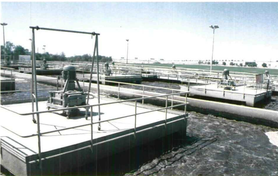
جانب من محطة لتجميع مياه الصرف الصحي.
