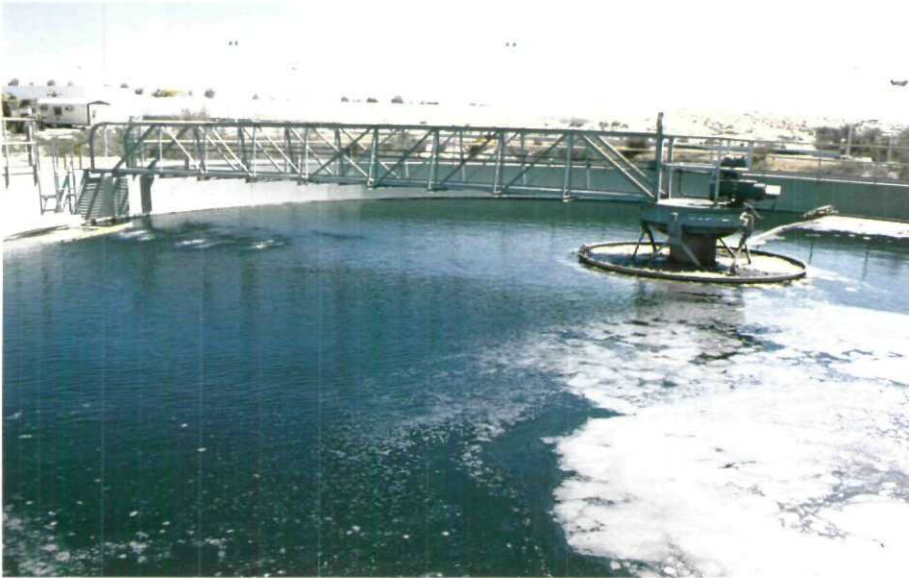
يتم تجميع مياه الصرف الصحي في خزانات ضخمة، لترسيب المواد الصلبة مثل الرمل والحصى.
