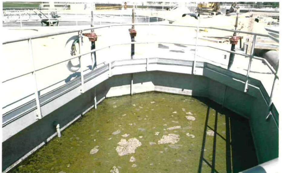
إحدى برك تجميع المياه المعالجة.
