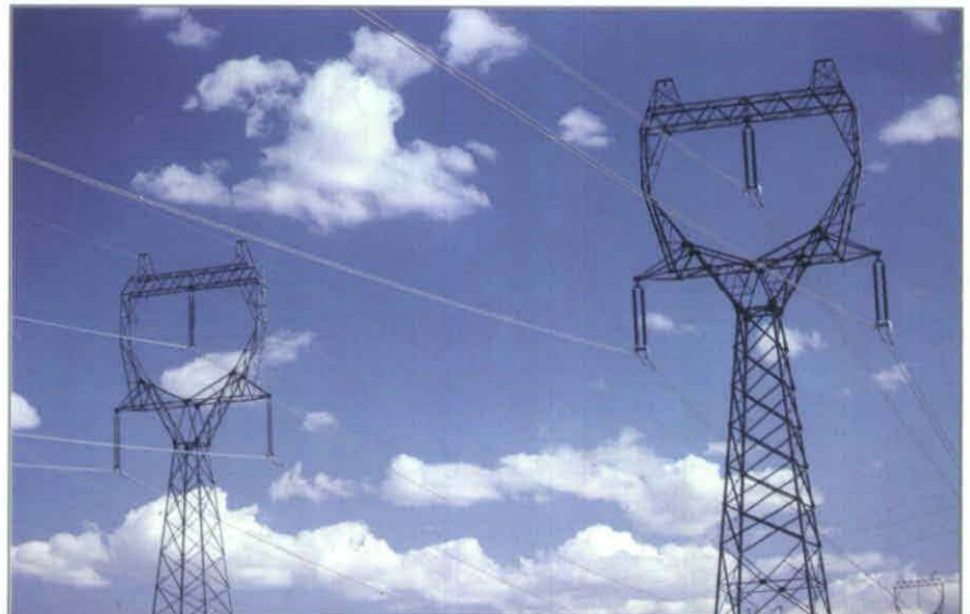
● توضح الصورة عدداً من الأبراج المستخدمة لنقل الطاقة الكهربائية عبر الأسلاك المعلقة .
