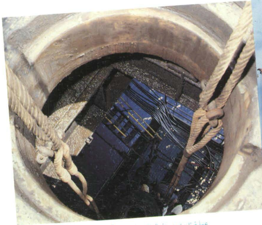
عملية تثبيت وربط المثقب في نهاية أنبوب فولاذي لمواصلة عملية حفر بئر بفق ٣٣٦.
