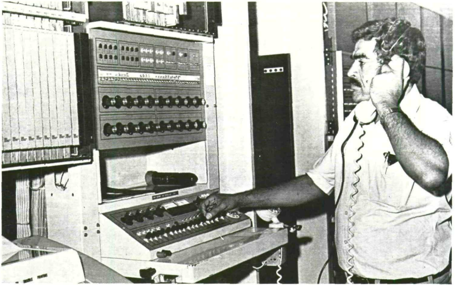
الفني حجي قاسم الدوسري من قسم الهاتف الآلي في ارامكو يفحص احد خطوط الهاتف بواسطة جهاز الكتروني حديث .
